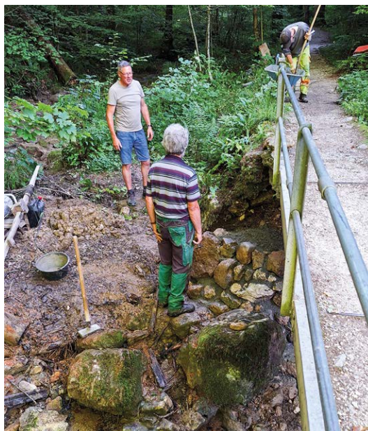
Ein Brückenlager muss neu aufgemauert werden.
