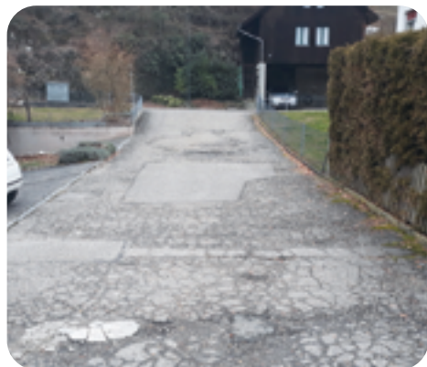
Sanierung Auweg vorher
